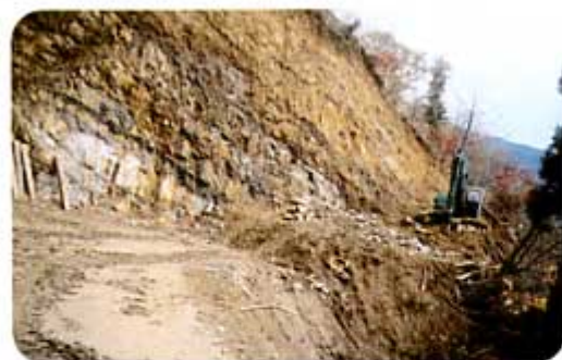
林道工事による自然破壊
