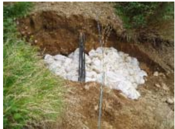
写真1 No.4と5の間の崩落地点 (05年8月)
